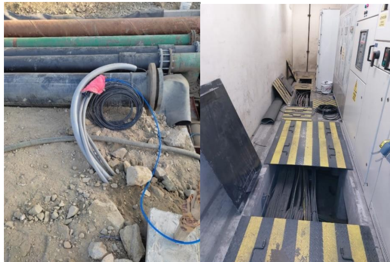
Figura 61. Canalización por bandejas en sala eléctrica (8)
