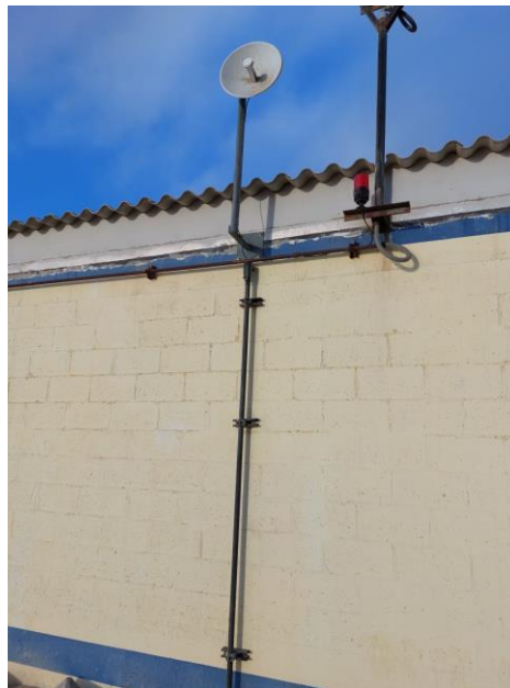
Figura 73. Canalizacion para antena
