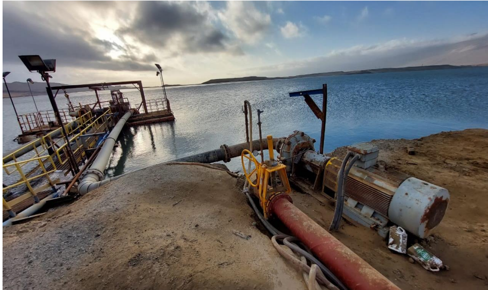
Figura 6. Motor 1 y motor 2 en el area de barcaza (3)
