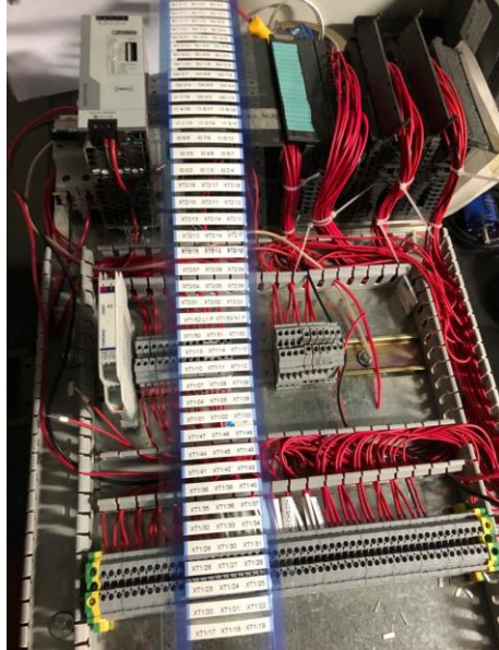
Figura 57. Proceso de codificación de cableado (2)
