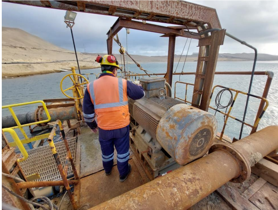
Figura 7. Personal operador, regulando frecuencia en barcaza (3)
