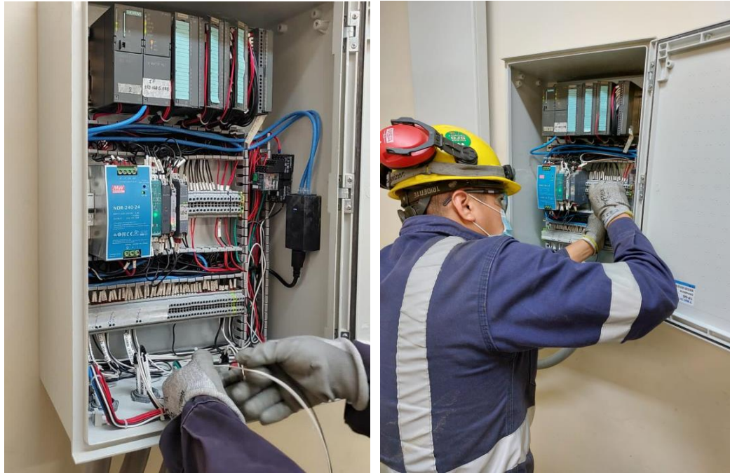
Figura 75. Conexión de los VDF y demás circuitos al tablero de control realizados por el bachiller
