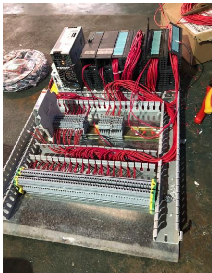
Figura 56. Cableado y conexionado del circuito de control de acuerdo al diagrama (2)
