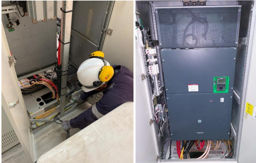
Figura 62. Canalización de cables de señal desde UVF
