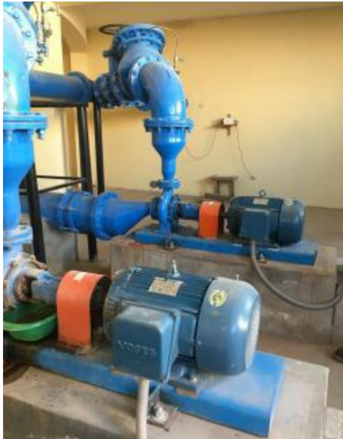
Figura 22. Cámara de bombeo del reservorio R-2 para macro – medidor.
