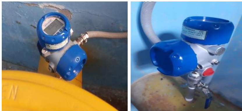
Figura 21. Sensores de presión Vega Krohne instalado en reservorio.
