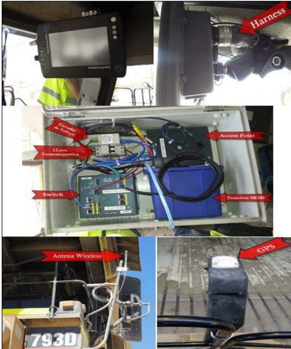
Figura 33. Hardware Dispatch instalado en camiones por la Empresa Minera Antamina. 2021.
