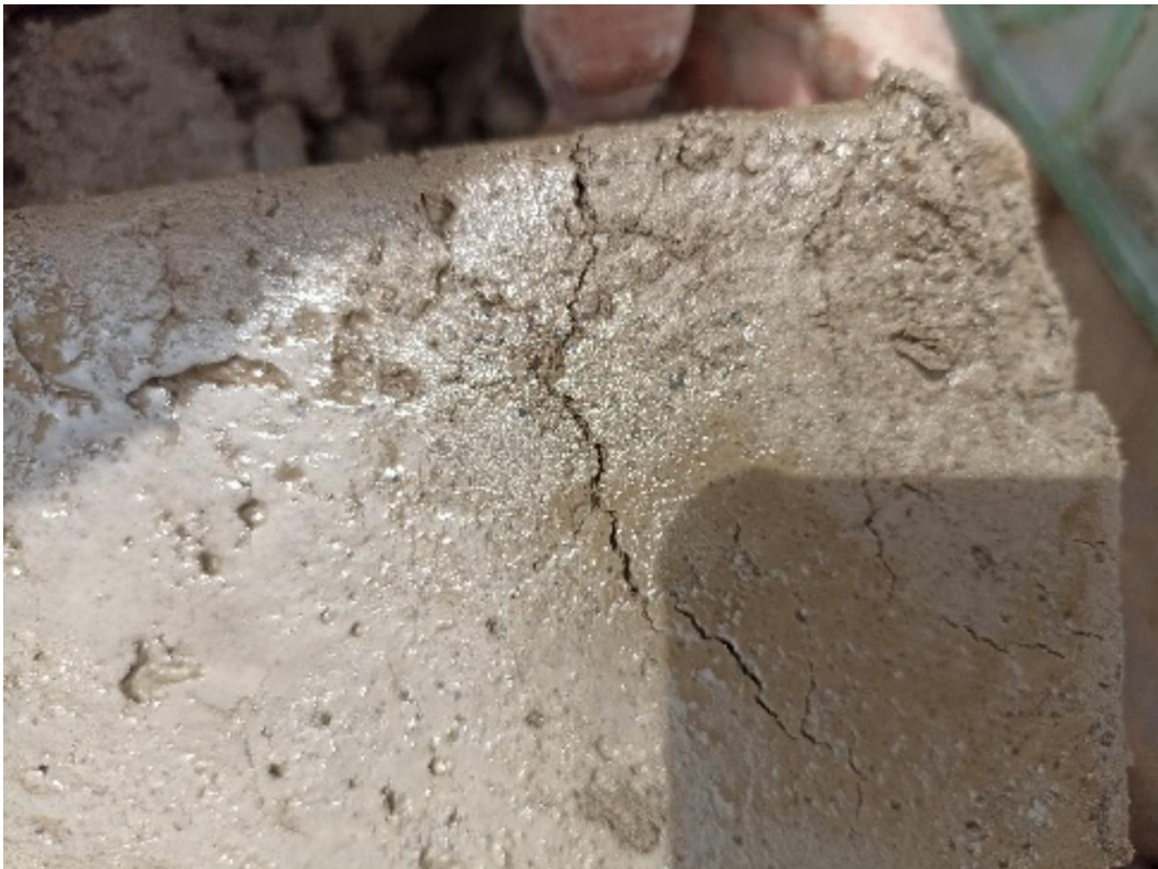
Fotografía 20. Fisuración por contracción plástica en el concreto
