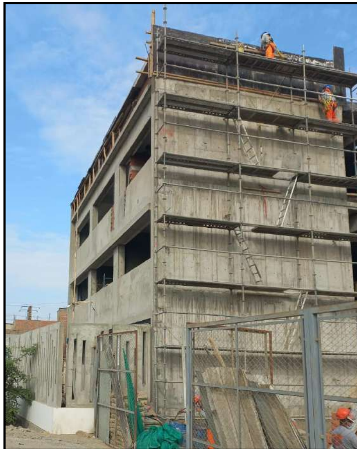
Figura 14. Proceso de ejecución de casco arquitectónico (albañilería, tarrajeos y revoques) Tomada de Informes mensuales
