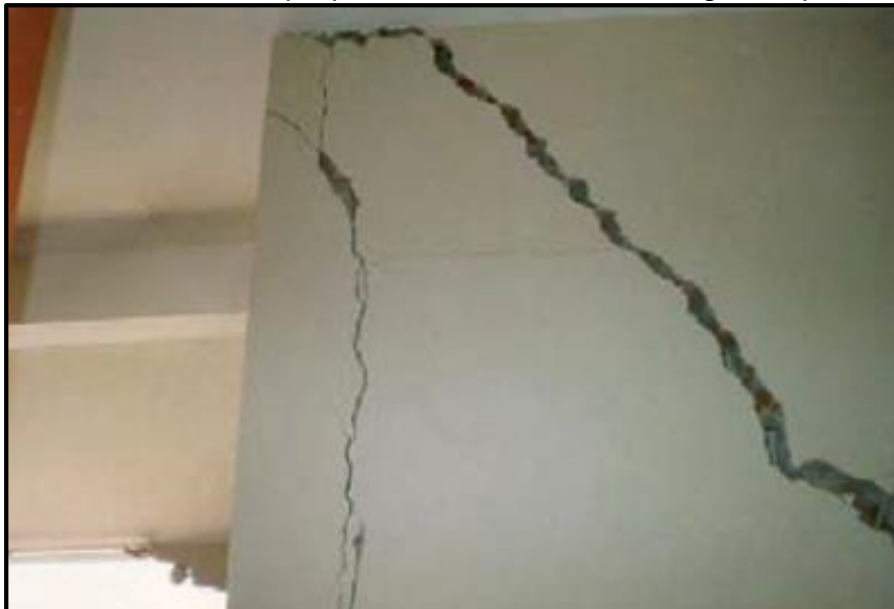
Figura 1.1. Agrietamiento por fuerza cortante. Tomada de “Construyendo con Juan Seguro”, por Aceros Arequipa, 2012, p.7.
