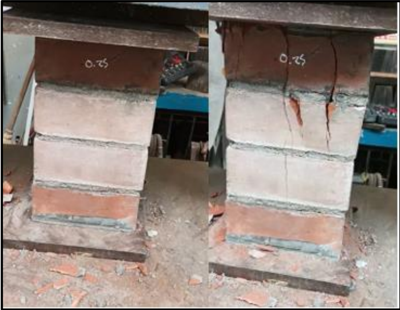
Figura 4.7. Pila PL_01 ensayado con la falla obtenida.
