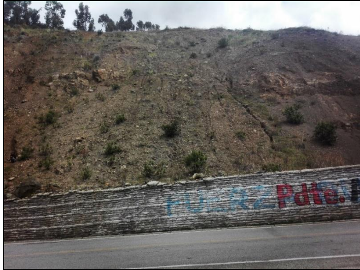
Surcos de agua en el talud producto de las precipitaciones pluviales
