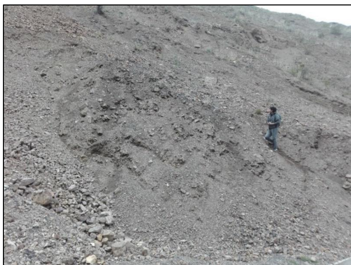
Deslizamiento activo el km 628+300 en la carter PE-3S
