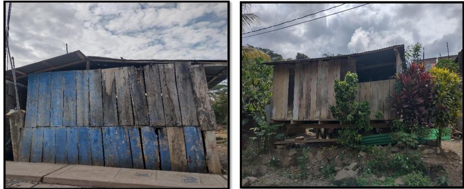
Figura 2. Fotografías donde se evidencia el déficit habitacional antes del Programa Techo Propio en el CC.PP. de Kimbiri Alto - Kimbiri - Cusco.
