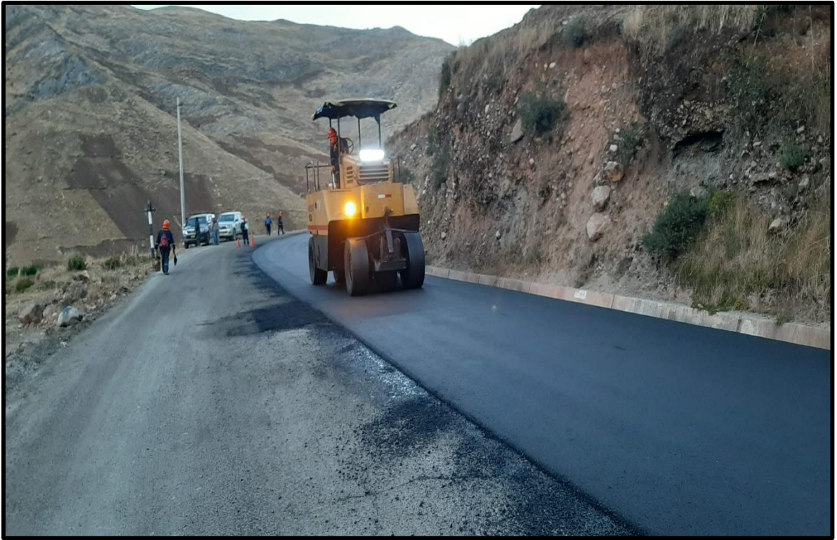
Foto 19: Compactación con rodillo neumático, para acabados y textura de la carpeta asfáltica
