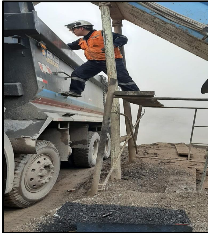
Foto 17: Control de temperatura de la mezcla bituminosa base en planta para ser enviada a campo
