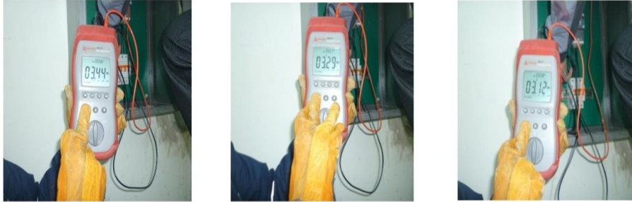
Figura 7. Medición de aislamiento de conductor del pabellón de Mecánica Automotriz
