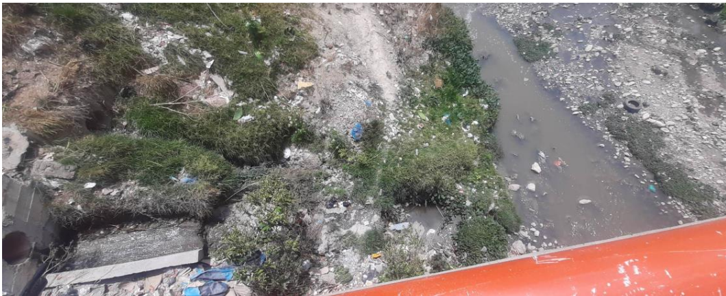
Fotografías 5, 6 y 7. Descarga de aguas residuales - Puente Carrión. Se observan riberas del río Shullcas con presencia de desmonte y residuos de demolición, así como la presencia de residuos sólidos y de gestión no municipal en el caudal del río Shullcas.
