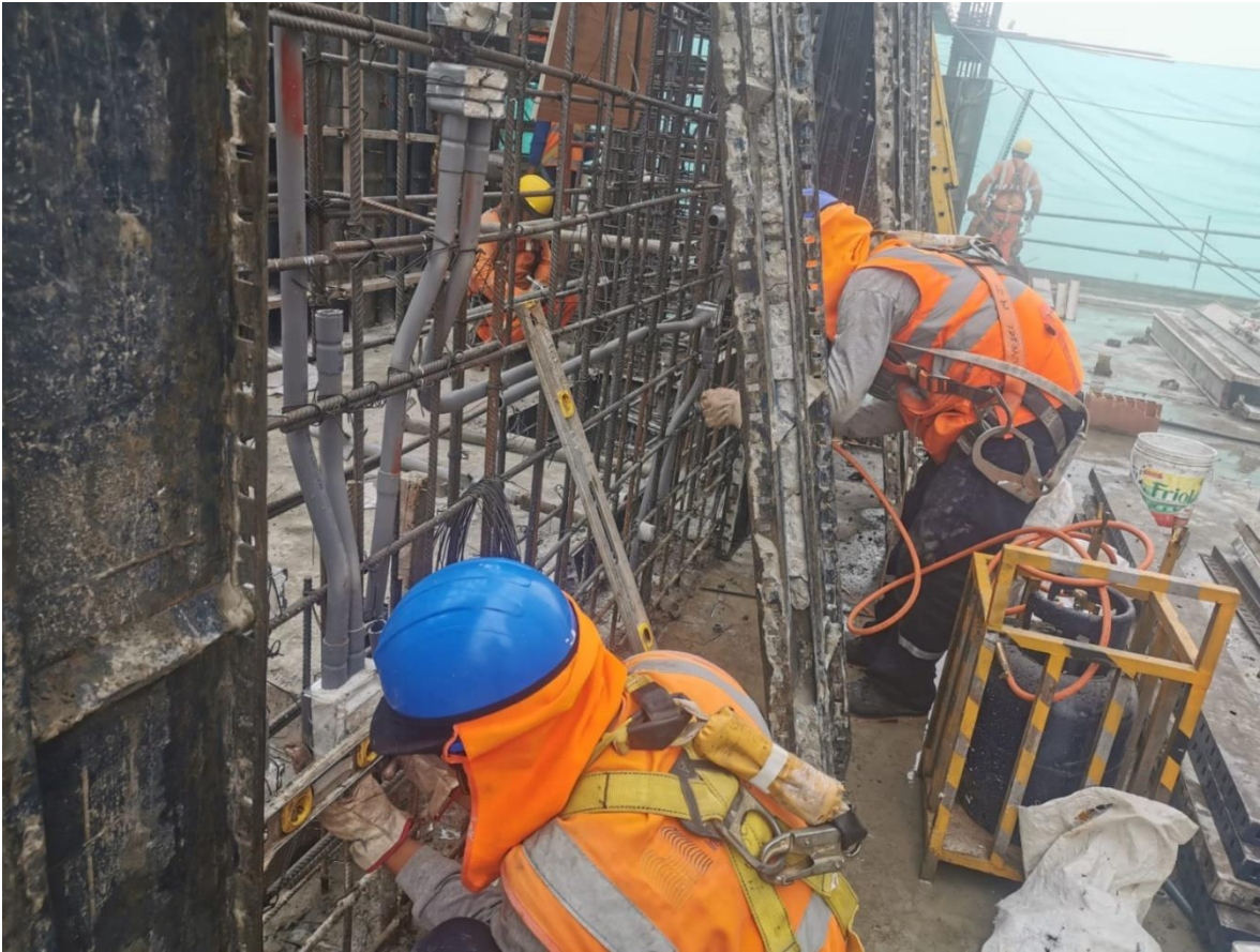
Foto 5. Canalizado de tuberías PVC y cajas de f°g° en placas de concreto
