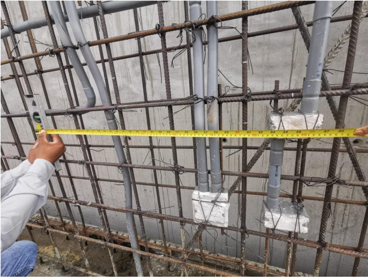
Foto 8. Liberación de ubicación y material de las instalaciones previo al encofrado y vaciado
