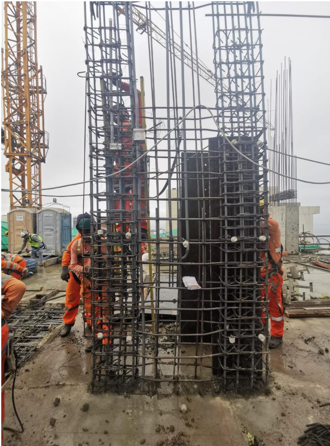
Foto 6. Canalizado de tuberías PVC y cajas de f°g° en columnas de concreto
