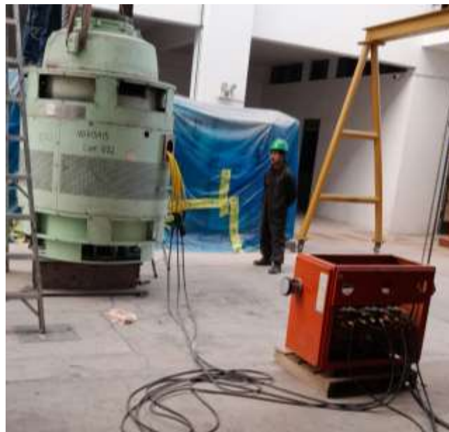
Figura 55. Arranque de motor de Media Tensión con autotransformador Fuente. SELCAF SAC.
