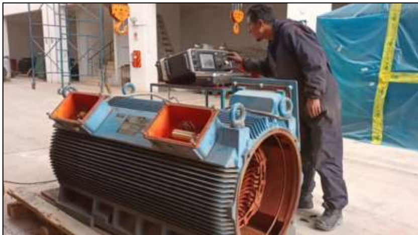
Figura 8. Operación de equipos de medición en motores. Fuente. Empresa SELCAF S.A.C.
