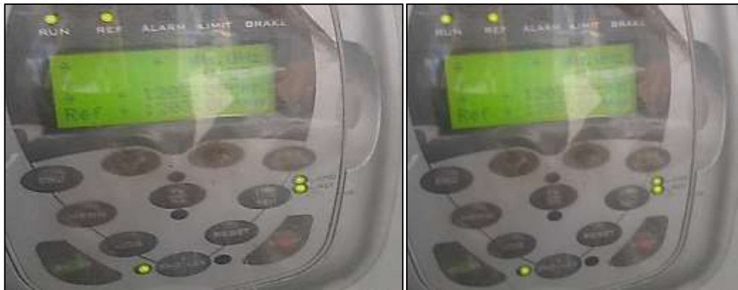
Figura 39. Variador Paso 3 y 4. Fuente: Empresa SELCAF S.A.C.
