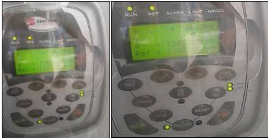
Figura 38. Variador Paso 1 y 2. Fuente: Empresa SELCAF S.A.C.
