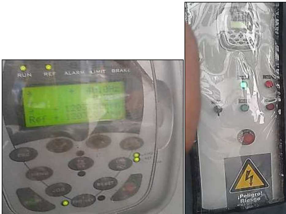
Figura 40. Variador Paso 6 y 7. Fuente: Empresa SELCAF S.A.C.
