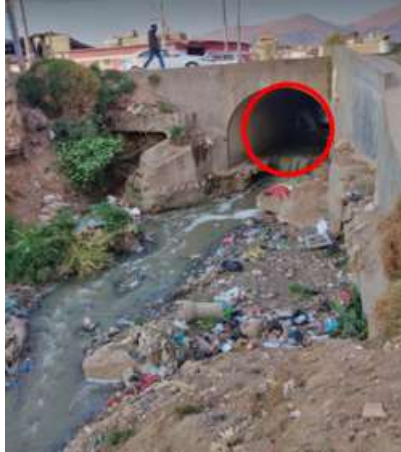
Figura 8. Residuos sólidos en el puente de la Av. Huancavelica y el Pje. Orellana.
