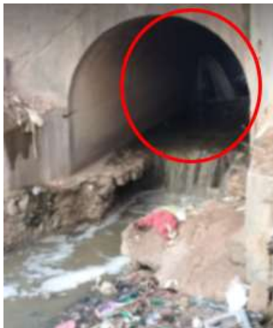
Figura 7. Descarga de aguas residuales del puente de la Av. Huancavelica.
