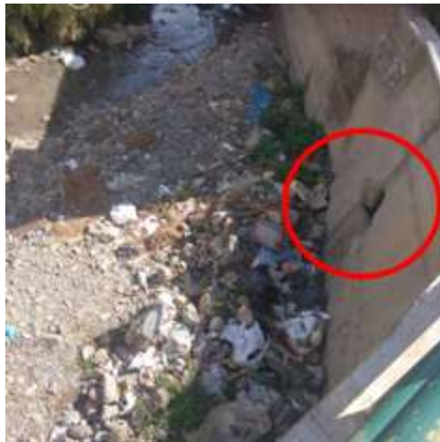
Figura 1. Tubería de descarga de aguas residuales de la Av. Jacinto Ibarra.
