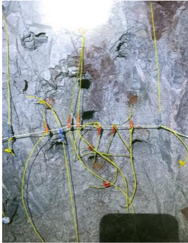
Figura 31. Tacos en el sistema de arranque
