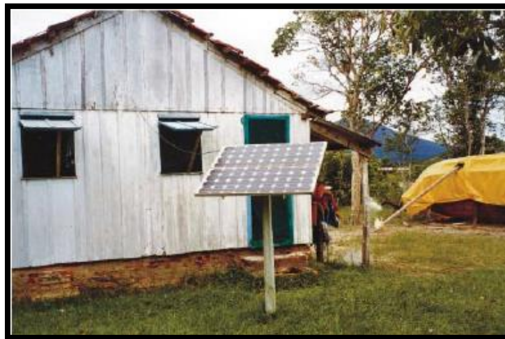
Figura 3. Sistema fotovoltaico autónomo.
