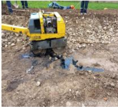
IMAGEN 17: Derrame de hidrocarburos por cambio de aceite.
