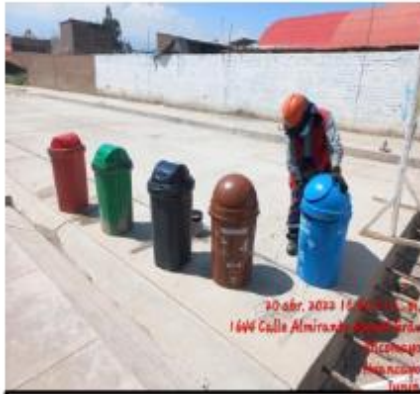
IMAGEN 08: Implementación de tachos para residuos sólidos en obra para el uso del personal.
