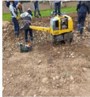
IMAGEN 18: subsanación de derrame de hidrocarburos.
