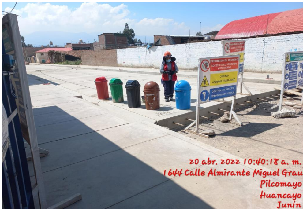
Figura 13. Implementación de contenedores.
