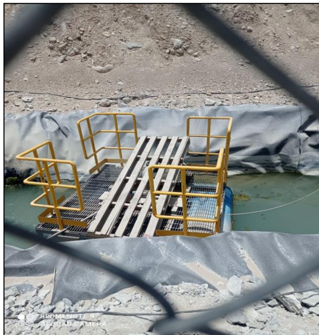
Figura 12. Barcaza de estación flotante de bombeo
