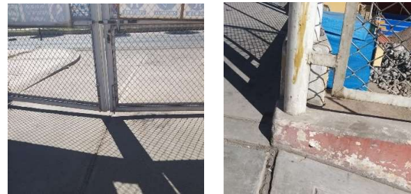
Figura 87. Estado de conservación del inmueble. Nota: Elaboración propia.
