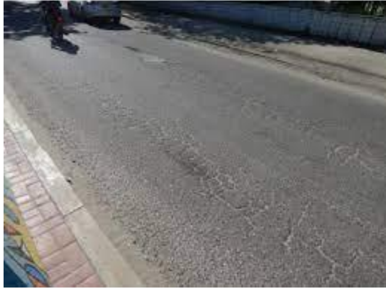
Figura 1 Fallas superficiales visibles sobre la carpeta de rodadura
