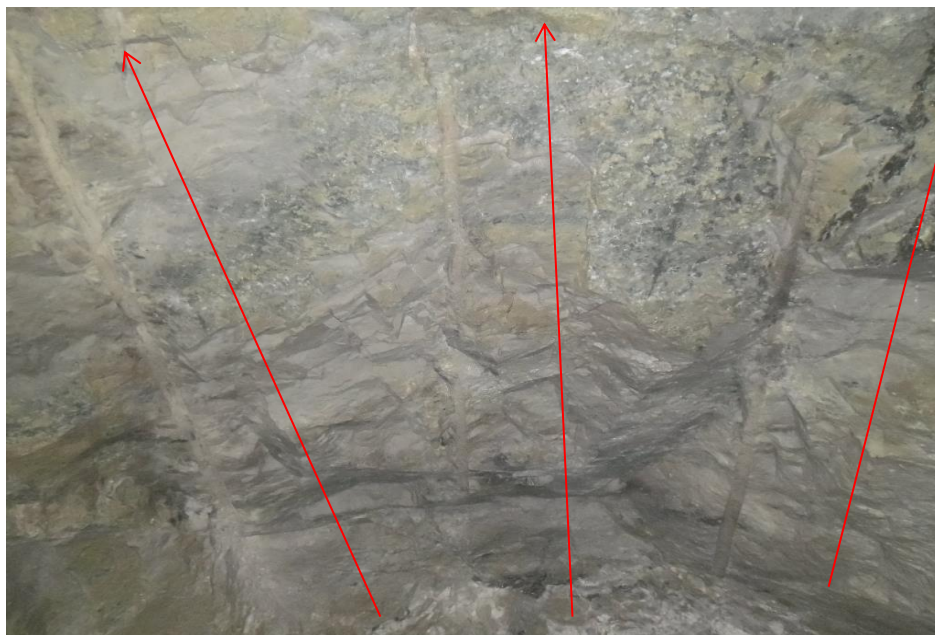
Figura 22. Cañas al 95 % de la Rampa 400, Nivel 82, unidad minera San Cristóbal
