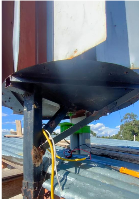
Figura 72. Vista completa del multiplicador de velocidad y turbina.
