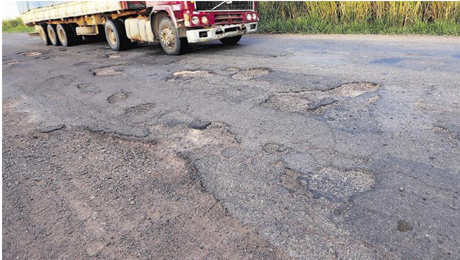
Figura 1: Vía en mal estado desprovista de mantenimiento adecuado
