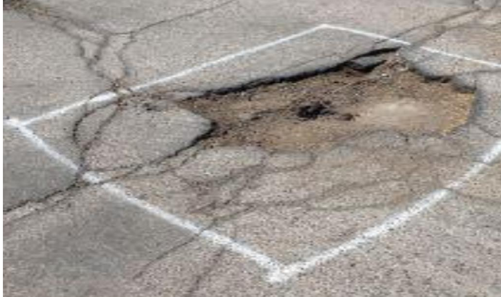
Figura 4: Bache en pavimento asfáltico
