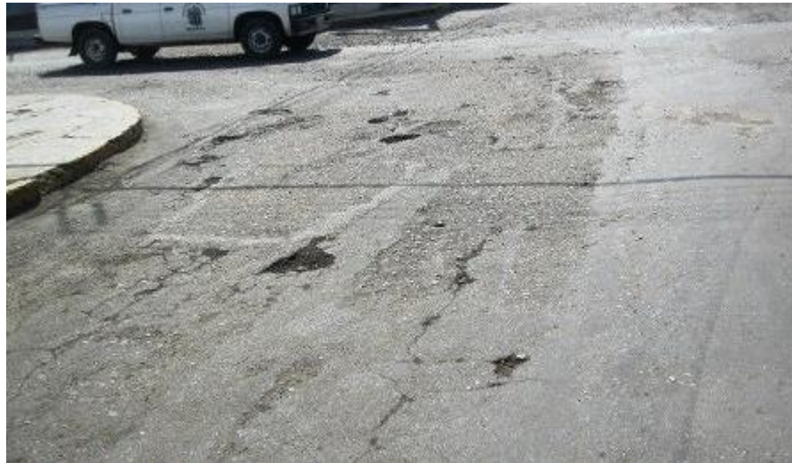
Figura 2: Situación de fallas superficiales en el pavimento asfáltico
