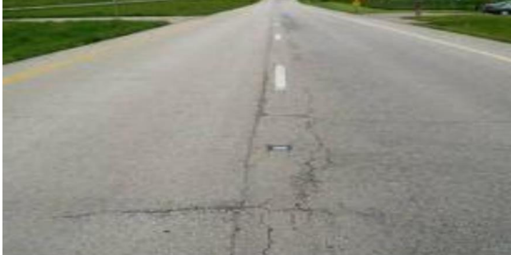
Figura 3: Grieta longitudinal en pavimento asfáltico
