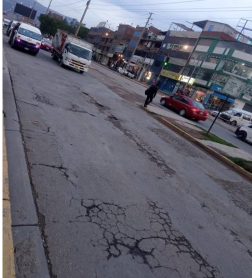
Figura 1. Fallas típicas que presentan los pavimentos flexibles en varios puntos de la ciudad de Huancayo.
