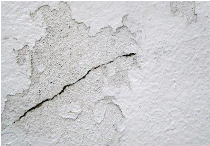
Figura 12 Fisura (abertura superficial)
