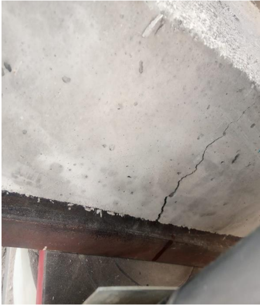
Rotura de viga de concreto con adición de 300 g/m 3 de microfibra de polipropileno
