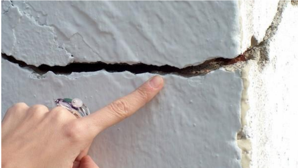
Figura 13 Grieta en columna estructural
