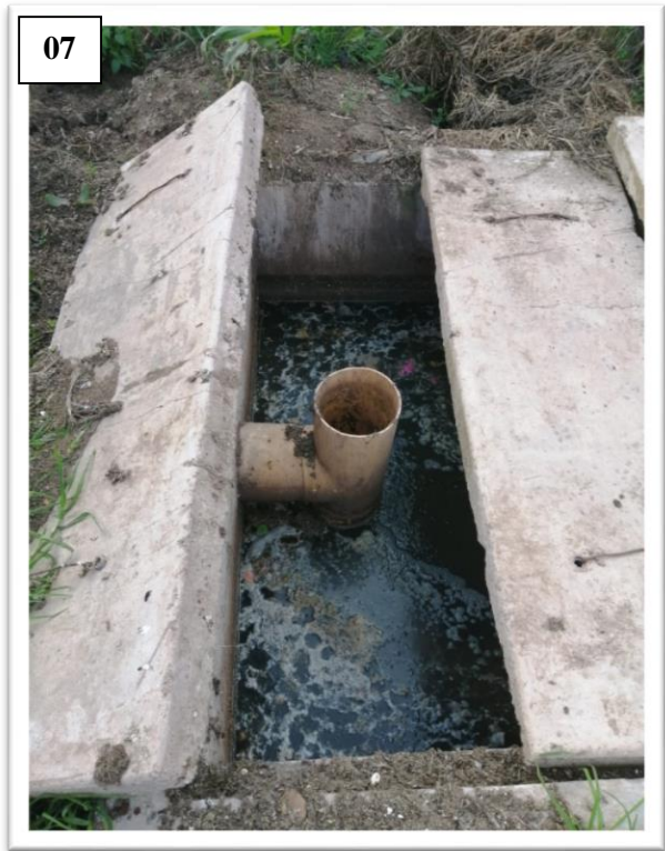
Fotografía N° 07. Trampa de grasas.
