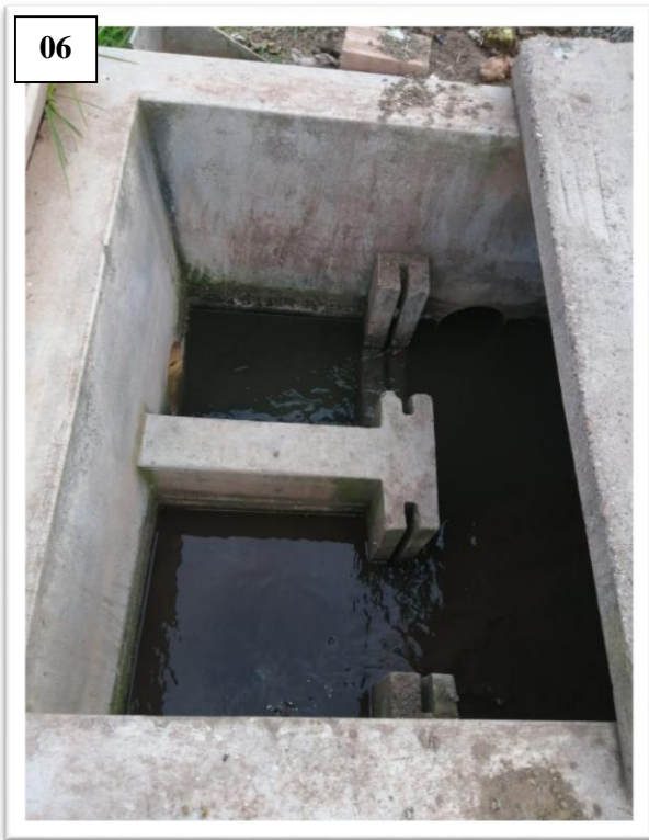
Fotografía N° 06. Sistema de compuertas abiertas para ambas lagunas de oxidación.
