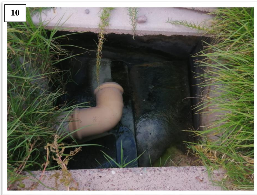
Fotografía N° 10. Salida del agua residual tratada.
