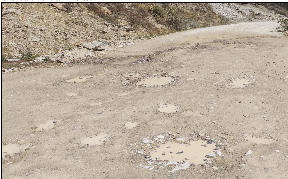
Figura 20: Identificación de fallas km 10+000
