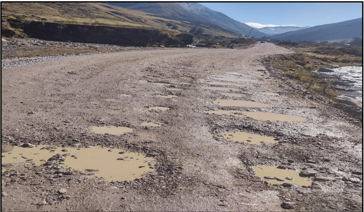
Figura 22: Identificación de fallas en el km 17+000
