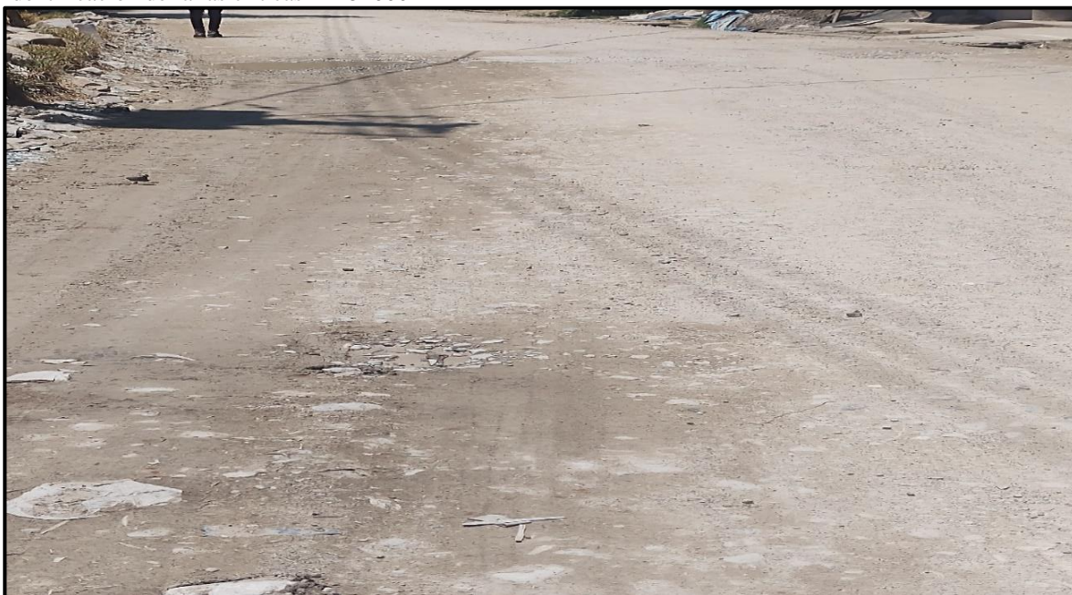
Figura 19: Identificación de fallas críticas km 8+000
