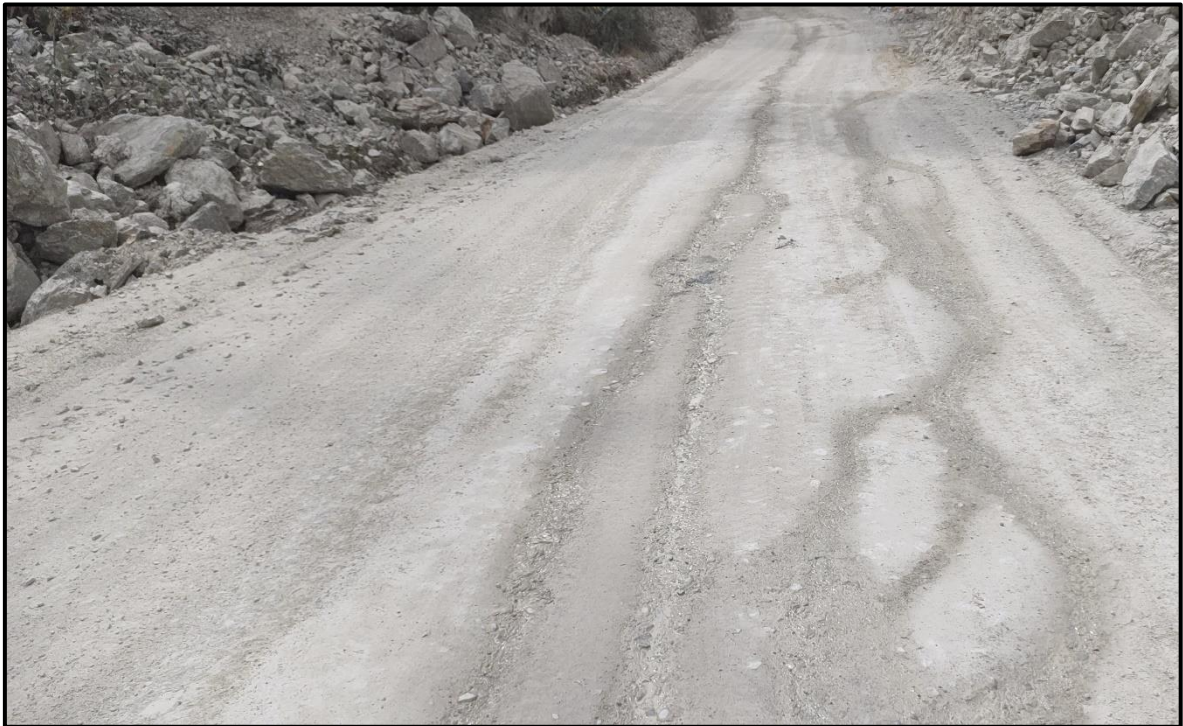
Figura 21: Identificación de fallas en el km 13+000
