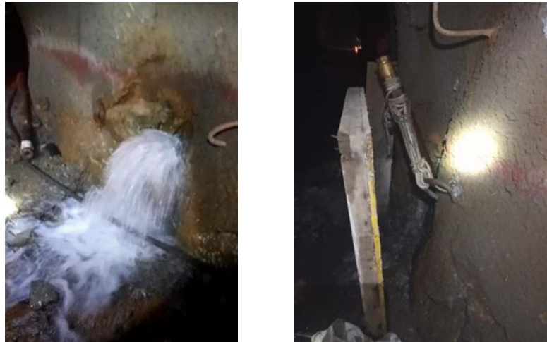
Figura 25. Presencia de fuga de agua en exploración
