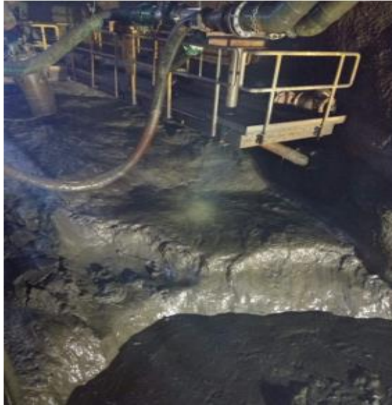
Figura 13. Acumulación de lama y detritos
