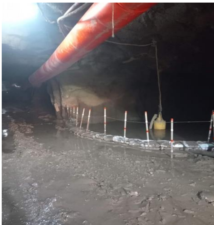
Figura 17. Operación bomba 58 HP
