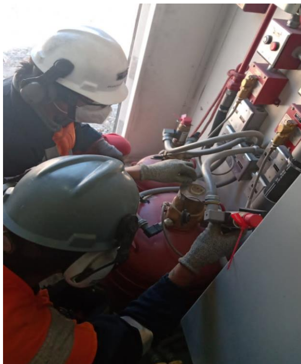
Figura 37. Inspección del equipo y dispositivos del sistema de protección contra incendios de la subestación móvil.
