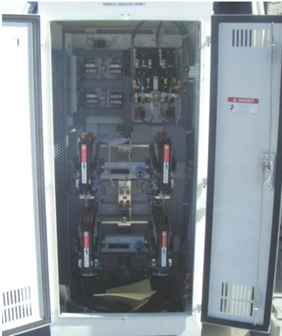
Cabina de transferencia
