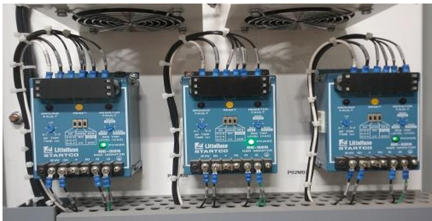
Relés de falla a tierra del transformador principal
