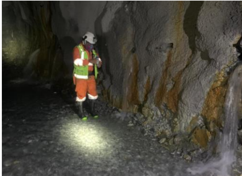
Figura 38. Taladros de drenaje ubicados en el hastial
