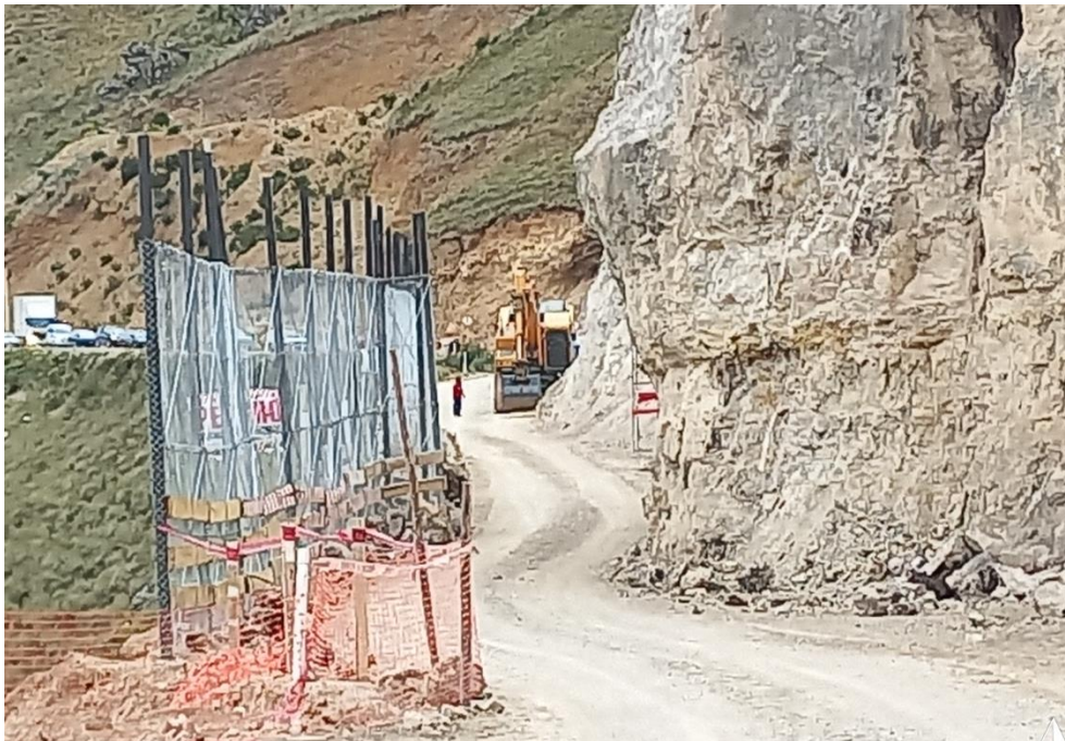
Figura 26. Señalización en mal estado
