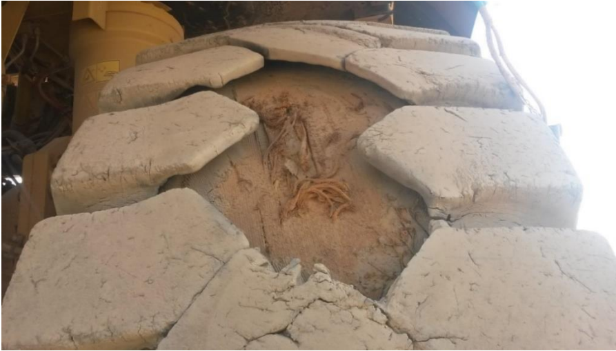
Figura 6. Falla por separación térmica.
