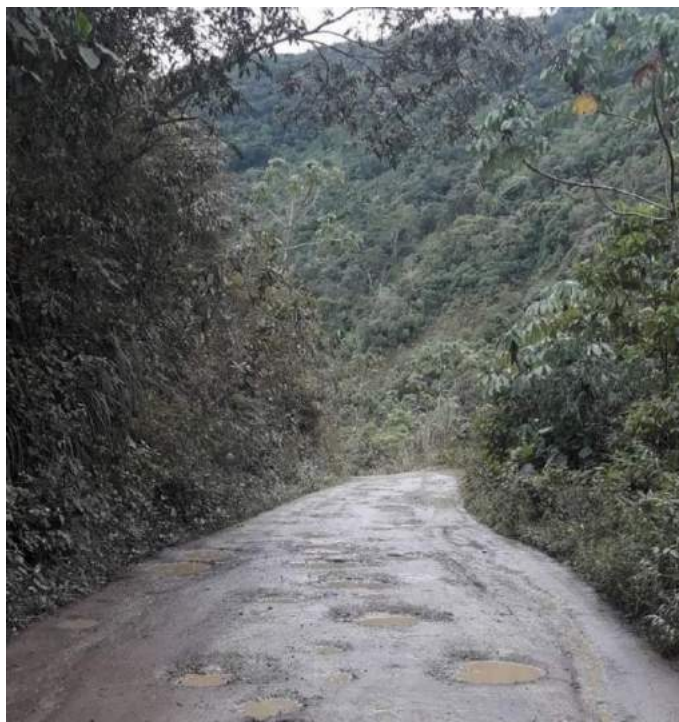
Fotografía 18. Estado de la carretera Sandia - Alto Inambari progresiva 17+800.
