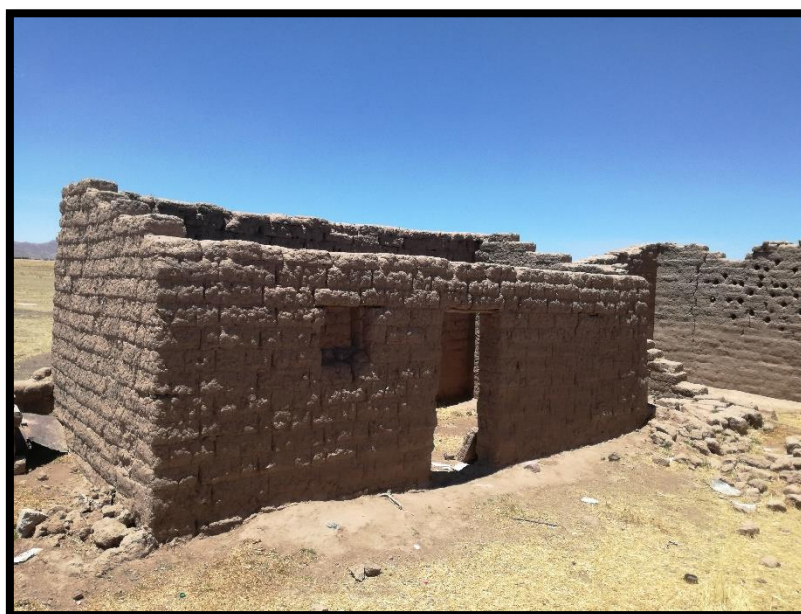
Figura 27. Vivienda beneficiaria abandonada.
