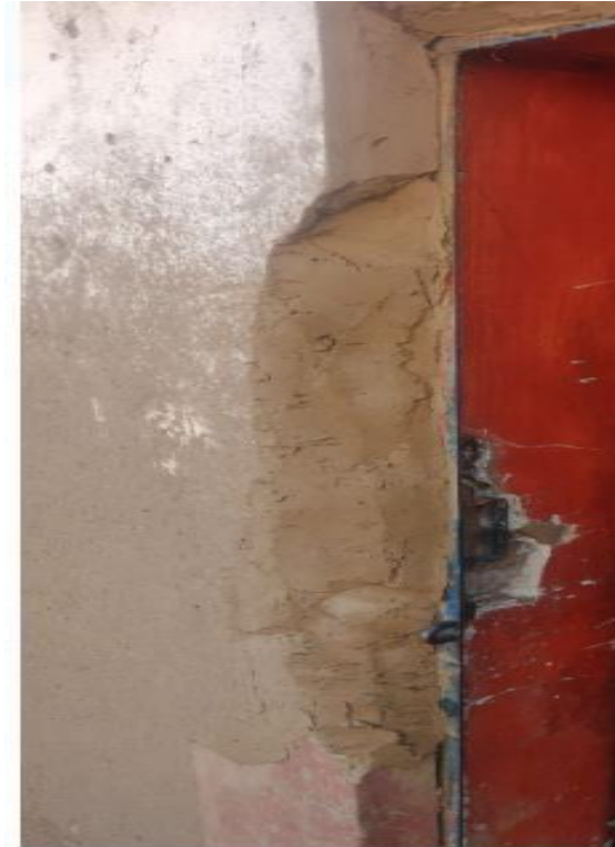
Figura 5. Deteriore de la vivienda de adobe
