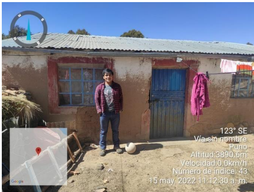
Ilustración 7 Vivienda antes de realizar algún trabajo, se presenta erosión por los agentes atmosféricos y deterioro.
