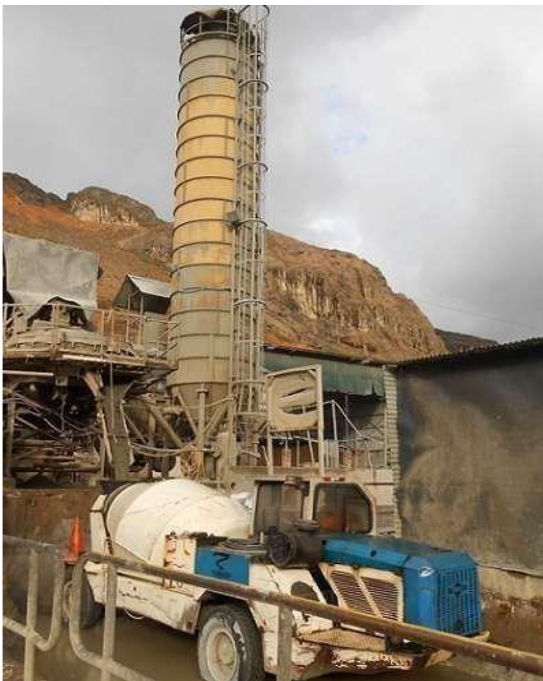
Figura N. 19. Abastecimiento de concreto a los Equipos Mixers en la Planta de San Cristóbal
