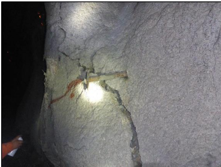
Figura N 23: Fisuramiento del concreto lanzado en la labor principal.
