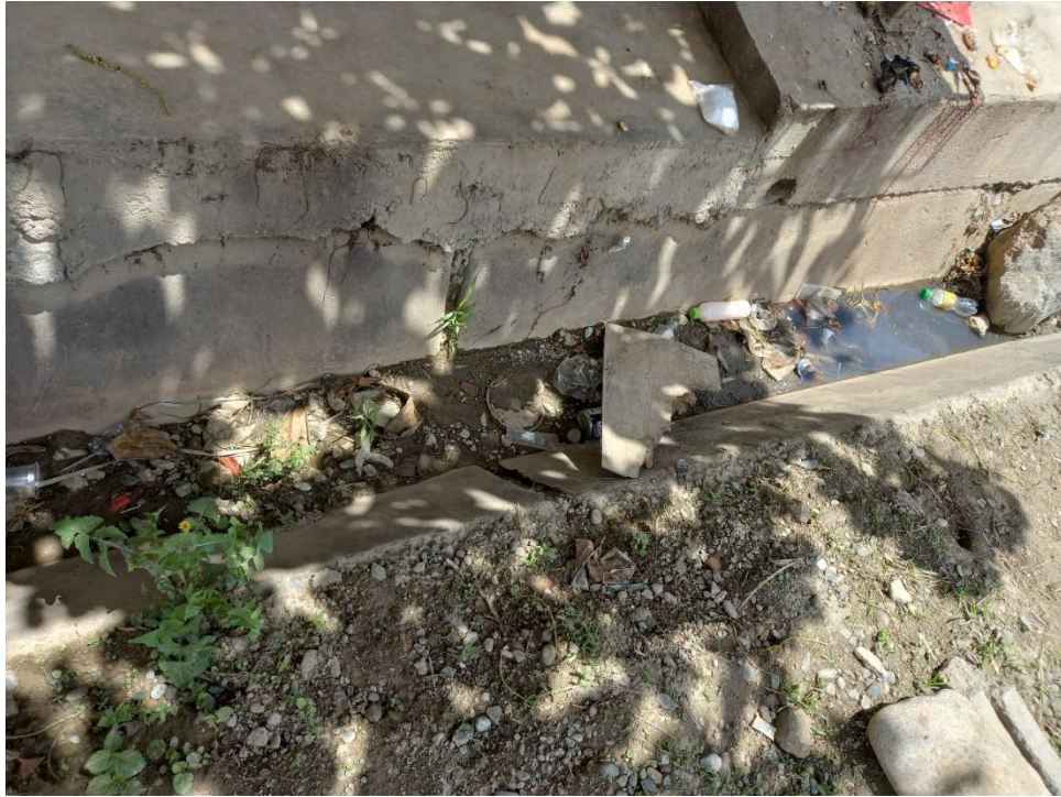
Se observa desechos en las calles y cunetas
