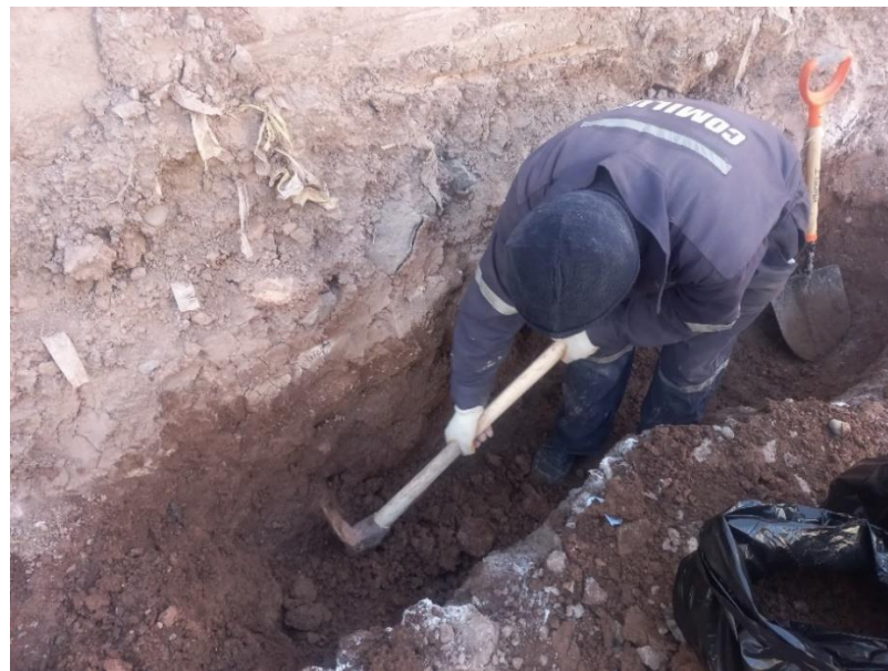
Apertura de calicata N°02 en el Jr. Huancané esquina con Jr. Tupac Amaru y recojo de muestra a 1.20 metros de profundidad.
