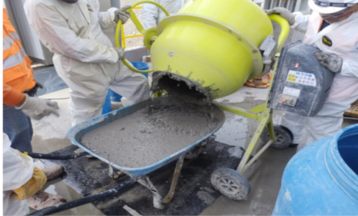
Figura 50. Mezcla de grout , UW y gravilla para el sellado hidráulico. Fuente: Elaboración propia
