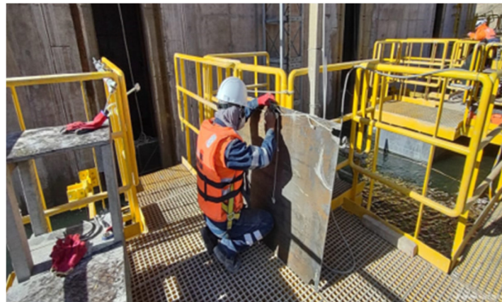
Figura 44. Verificación ajuste de pernos en placa de acero.
