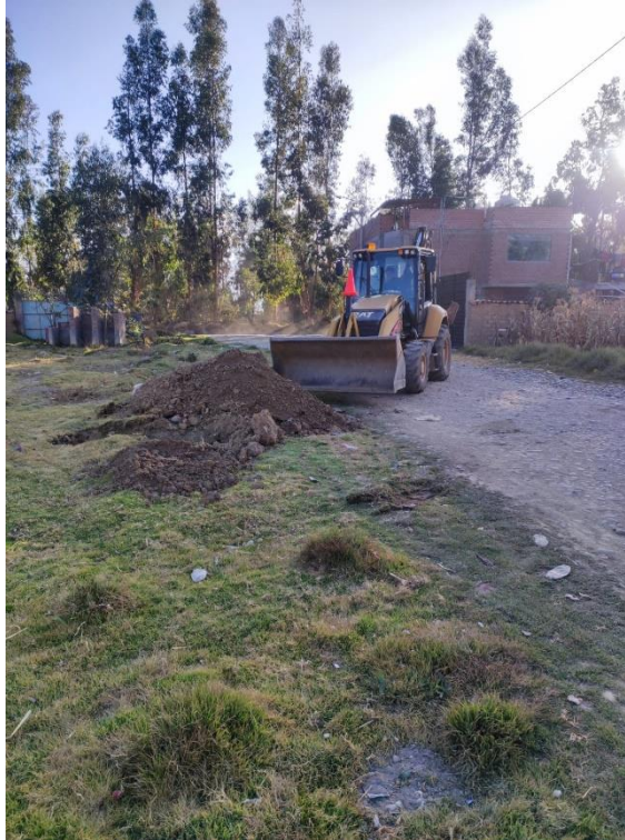
Fotografía 1. Se muestra el procedimiento de excavación con maquinaria de la muestra de suelo en la zona de estudio.
