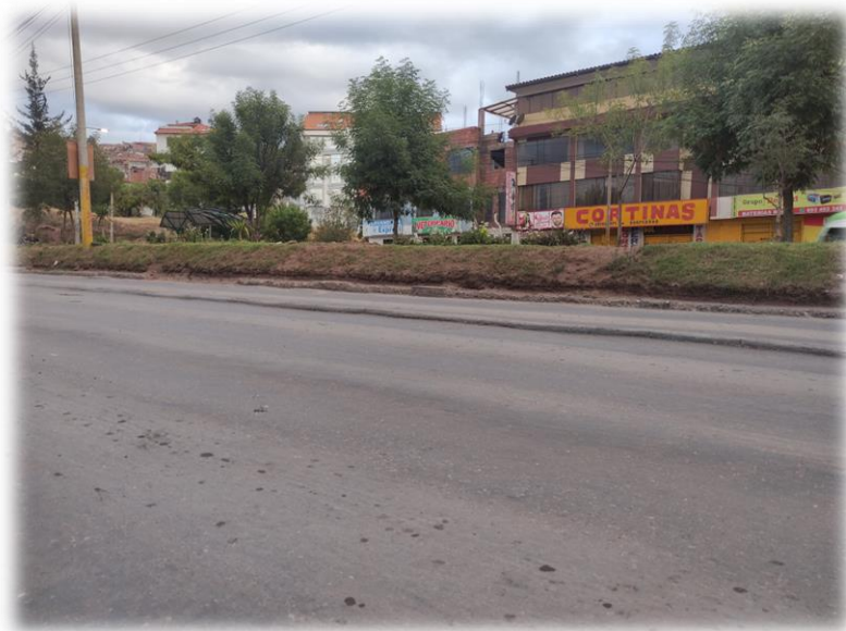
Figura 9: Falla de Exudación.
