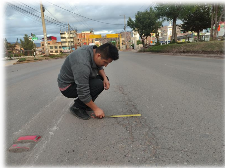
Figura 5: Falla de Piel de Cocodrilo.
