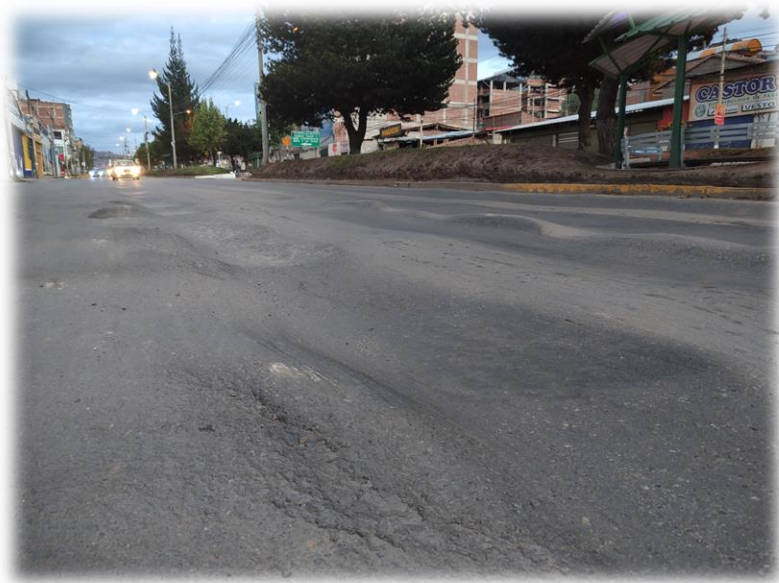
Figura 7: Falla de Corrugación
