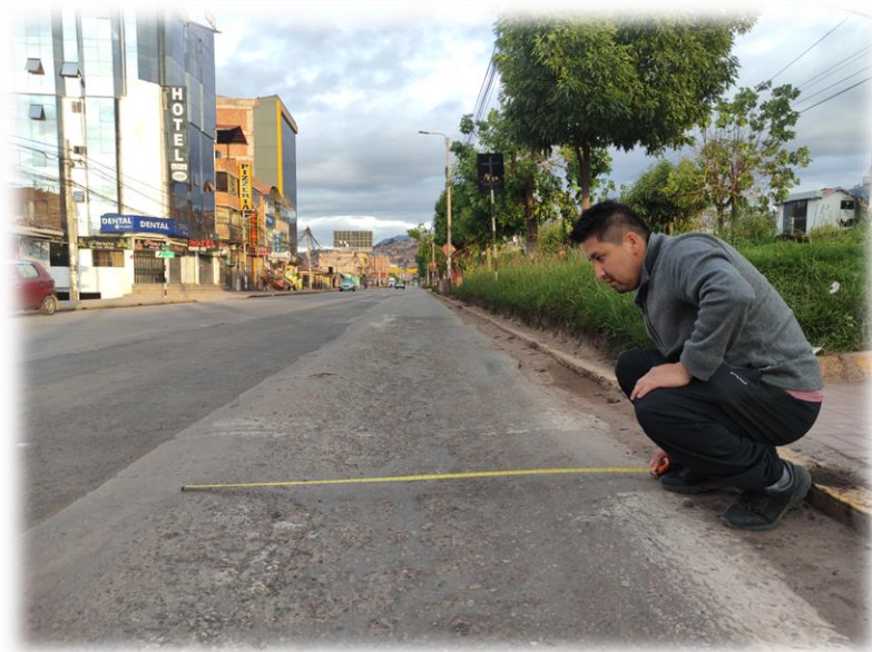
Figura 6: Falla de Parcheo
