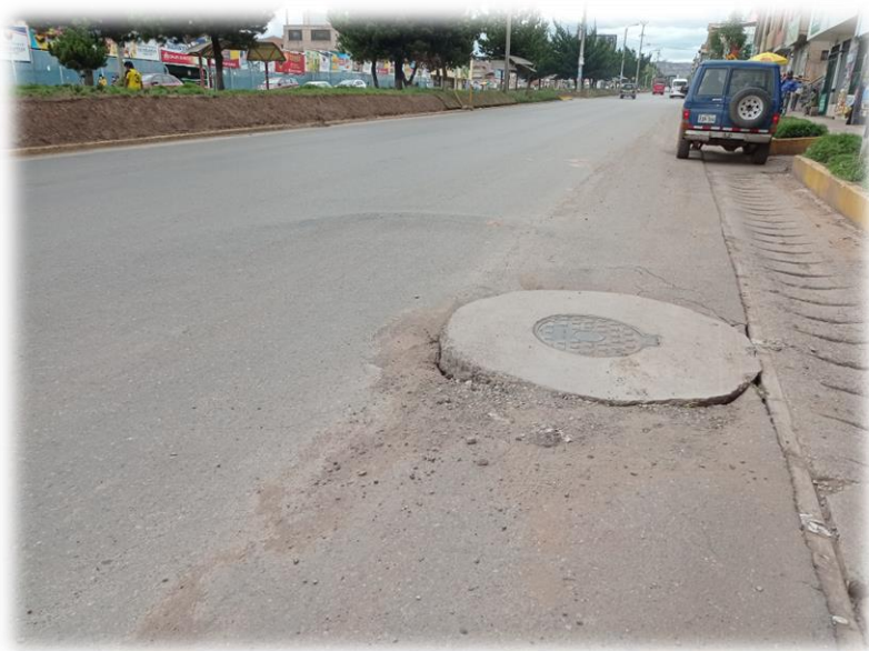
Figura 12: Fallas de Depresión.
