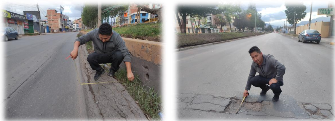
Figura 11: Falla de Desplazamiento y Desprendimiento de Agregados.
