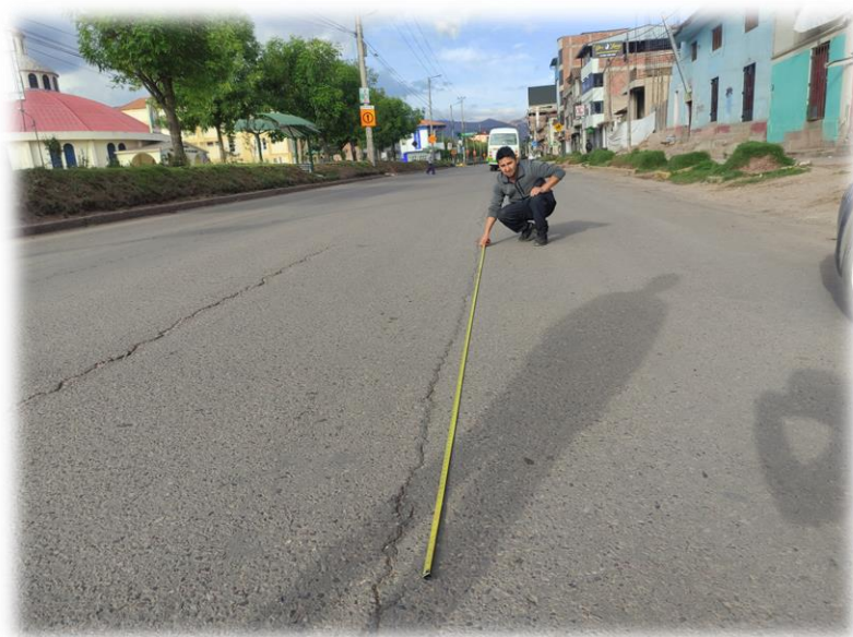
Figura 13: Falla de Grieta Longitudinal.
