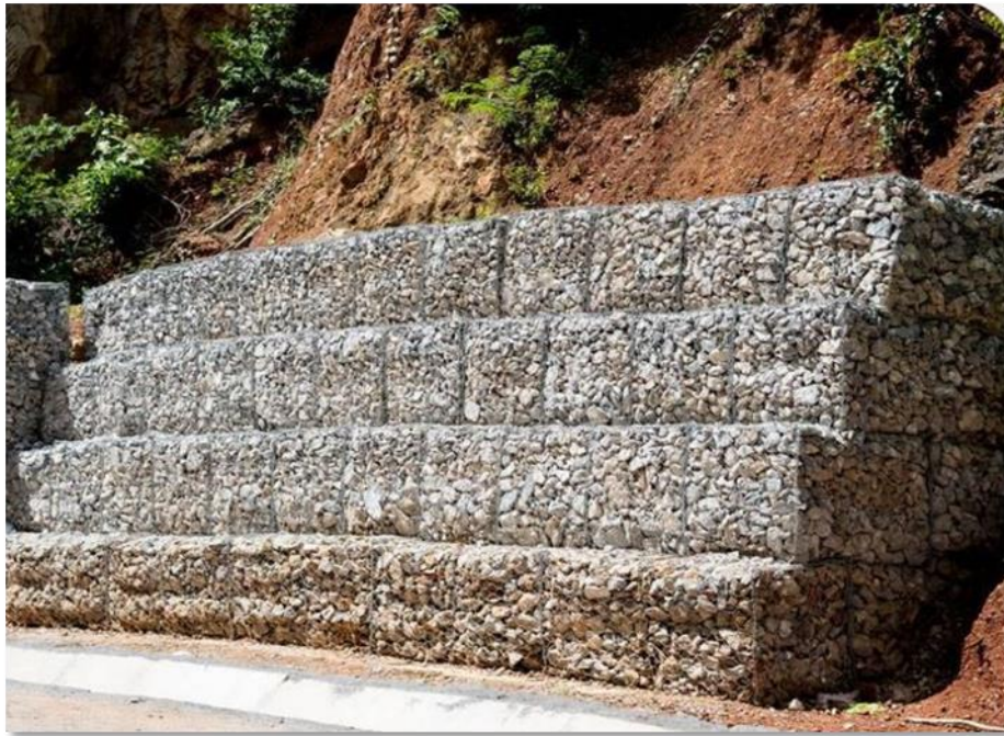
Figura 30. Imagen de gaviones Nota: Obtenido de Gaviones México (29)
