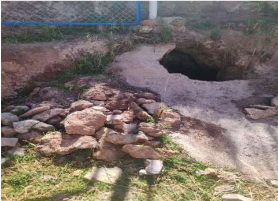
Figura 36. Estado actual del manantial Estange 2
