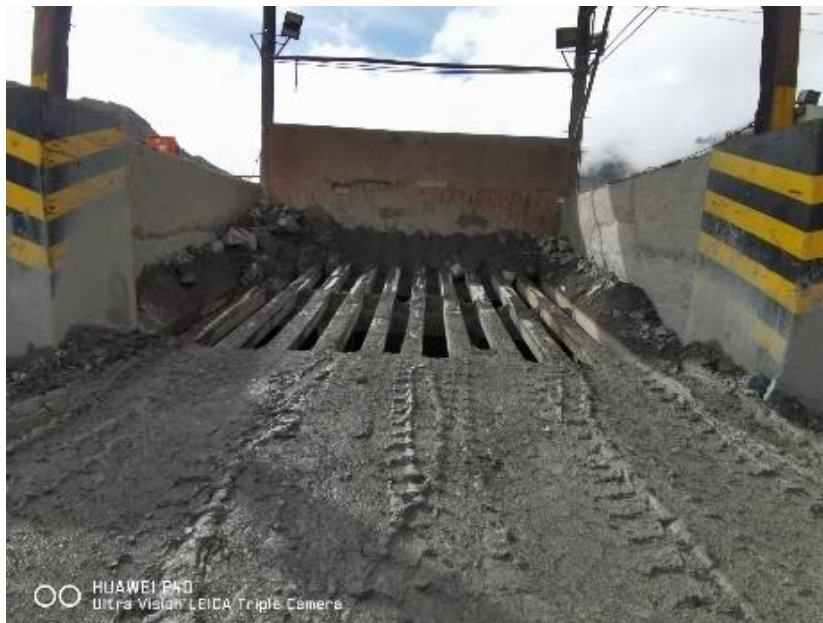
Figura 47. Parrilla fija en la tolva de grueso
