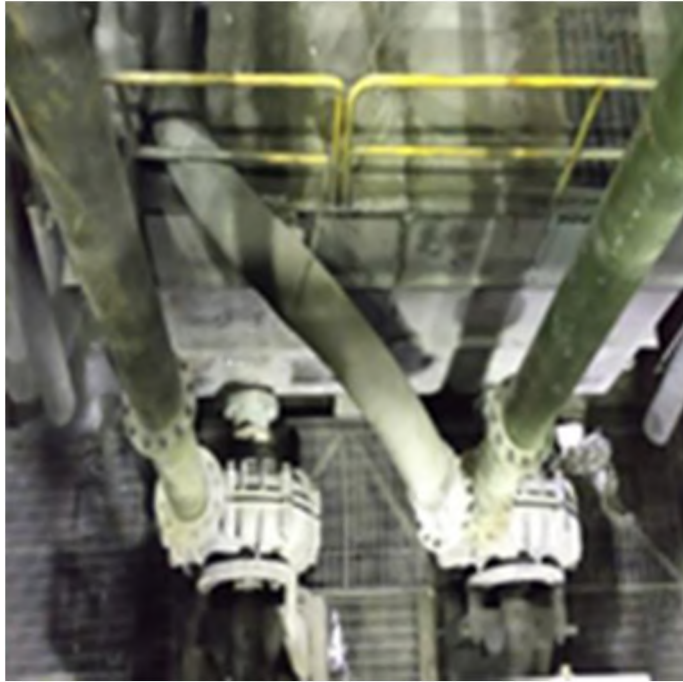
Figura 2. Líneas de conducción montadas 2A y 2B acopladas a la bomba Fuente: la minera El Brocal
