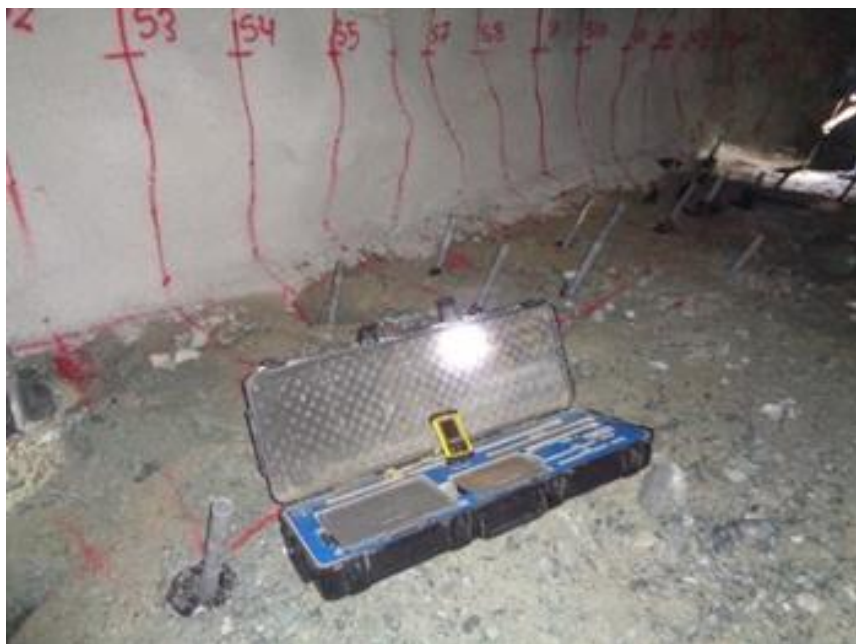
Figura 33. Taladros perforados tajeo 700 del Nivel 195 en la veta Fortunata, unidad minera Parcoy
