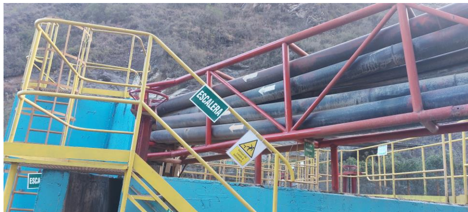
Figura 35. Infraestructura de la planta de tratamiento
