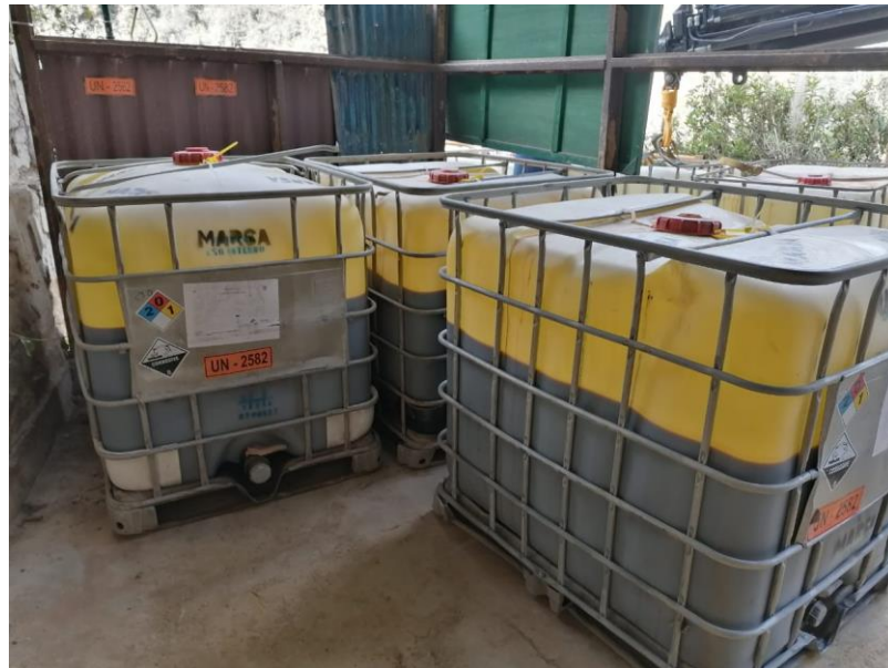
Figura 52. Cambio de isotanques de cloruro férrico
