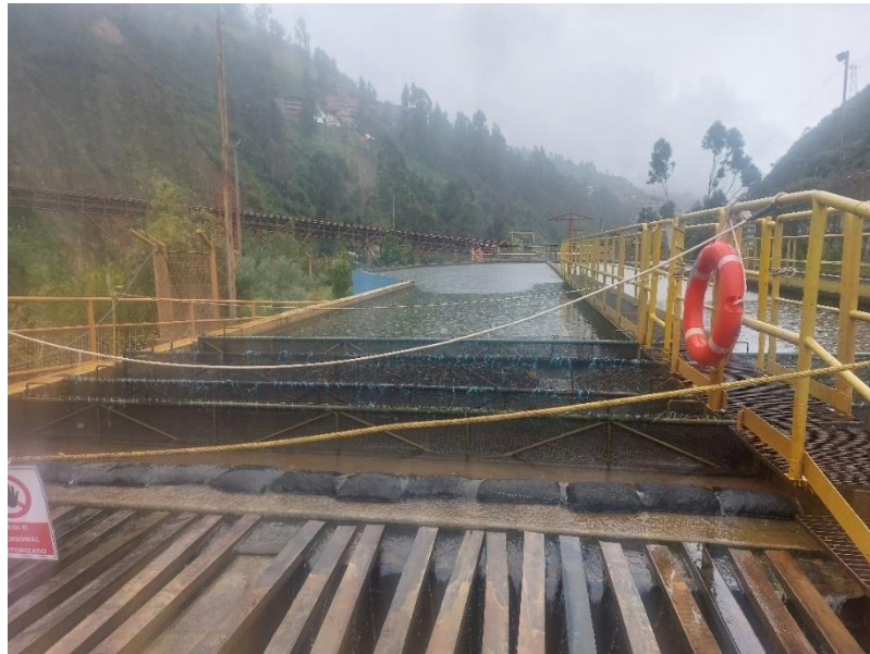
Figura 45. tratamiento del efluente en etapa de filtros
