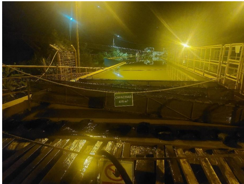
Figura 46. Tratamiento nocturno del efluente en etapa de filtros
