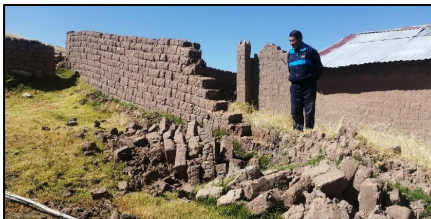
Figura 5. Pared de la Escuela 72073 de Ñaupapampa. Tomada de “RPP Noticias”, por Blas Condori, 2022.
