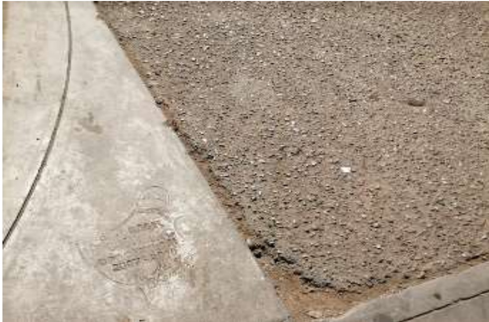
Figura 1: Desgaste de asfalto en las juntas con la vereda en la intersección Jr. Ricardo Palma y Jr. Arequipa
