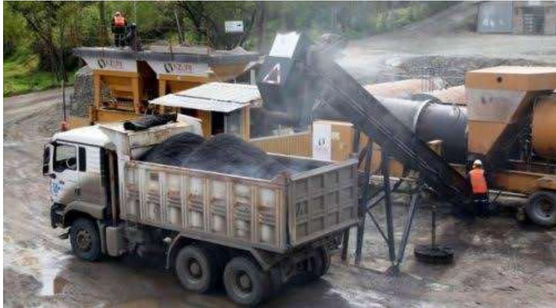
Figura 3: Proceso de producción del asfalto en planta.
