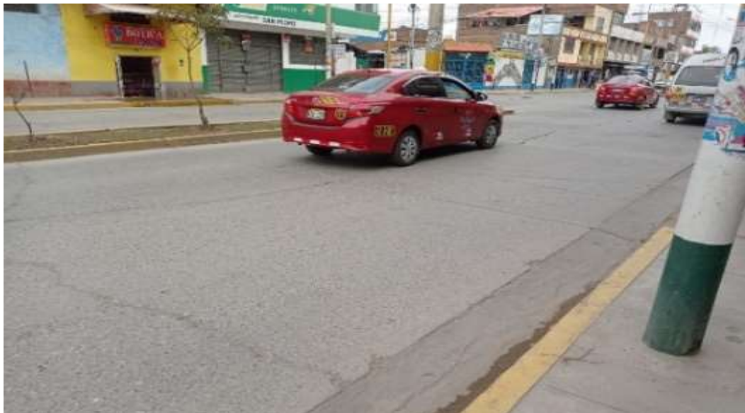
Figura 2: Desgaste del pavimento de la Av. Huancavelica, se puede apreciar el desgaste del pavimento con fisuras
